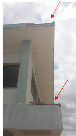
Parte da Fachada Danificada
